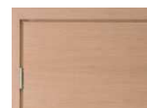
Opaski maskujące nie tworzą jednej płaszczyzny ze skrzydłem drzwiowym, zawiasy są widoczne.
